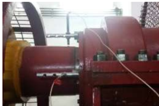
Fig. 3.3. Amplasarea traductoarelor de vibrații pe lagărul generatorului
