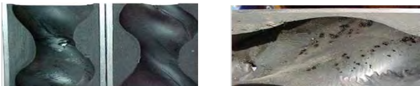
Fig. 2 – Deteriorarea prin abraziune
