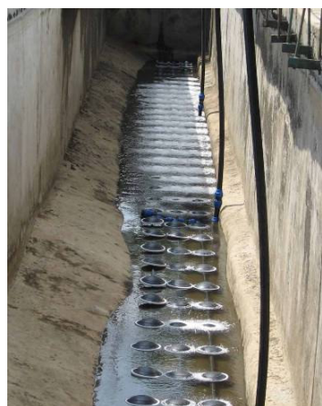
Fig. 2.4, Instalația de aerare din situ
