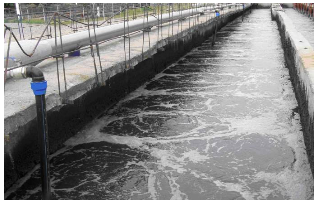
Fig. 6.2, Funcționarea instalației de aerare din bazinul beneficiarului
