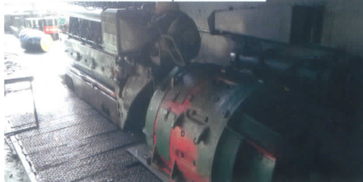
D3 - Stand de testare motoare Diesel - convertor static de putere
